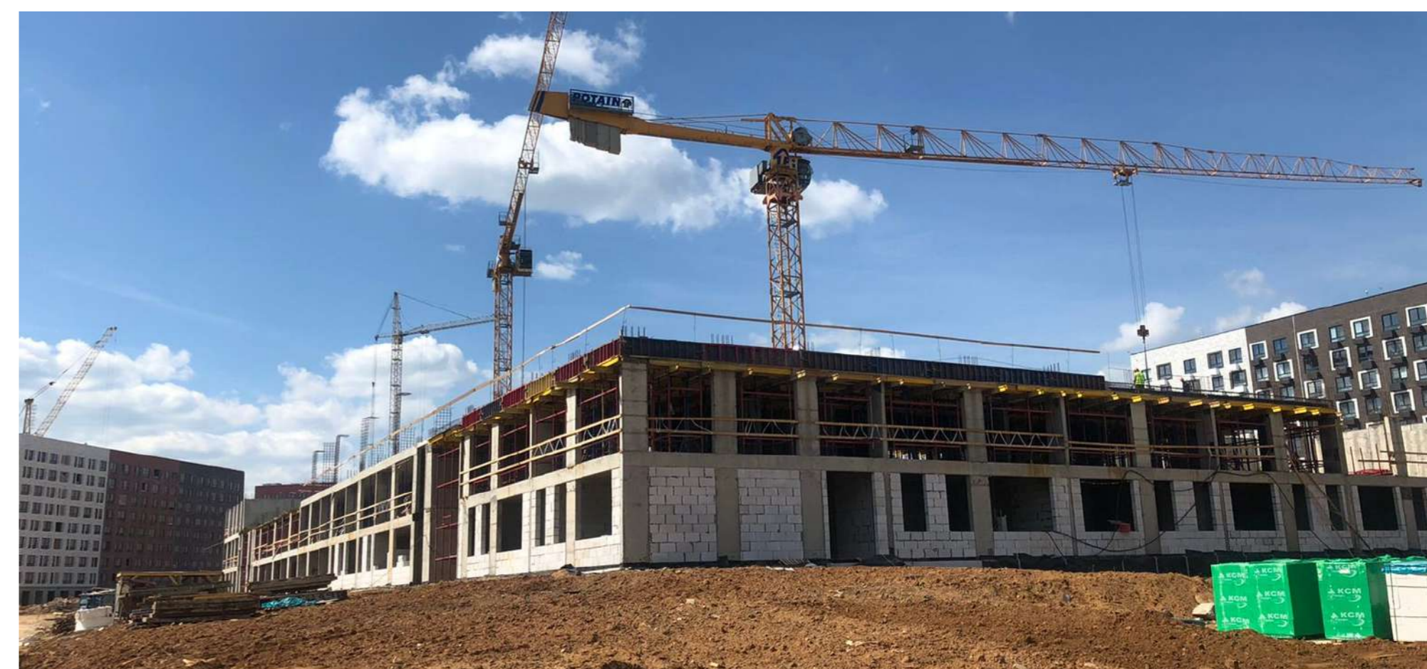
Лабораторное сопровождение строительства на объекте «Жилой комплекс, школа на 1500 мест, расположенная по адресу: Московская область, Красногорский муниципальный район, с.п. Ильинское, вблизи пос. Ильинское – усово»
